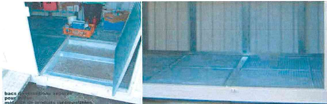
Photo n°6 : Exemple du type de rétention prévue.
